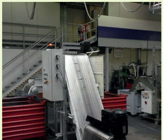
Jeweils zwei Pressen haben ein eigenes Schrott Abtransportsystem bekommen, mit Ansteuerung und Überwachung.
